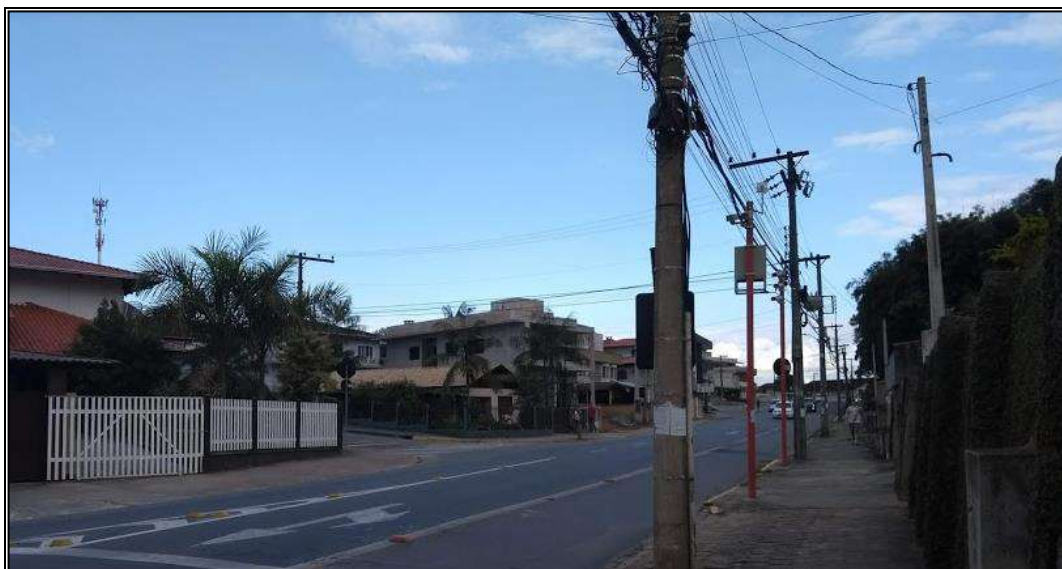
Figura 58: Instalação de rede de telefonia próxima ao empreendimento.
