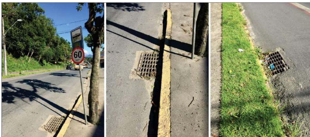
Figura 63: Drenagem pluvial rua Tenente Antônio João. Fonte: Acervo Pessoal.
