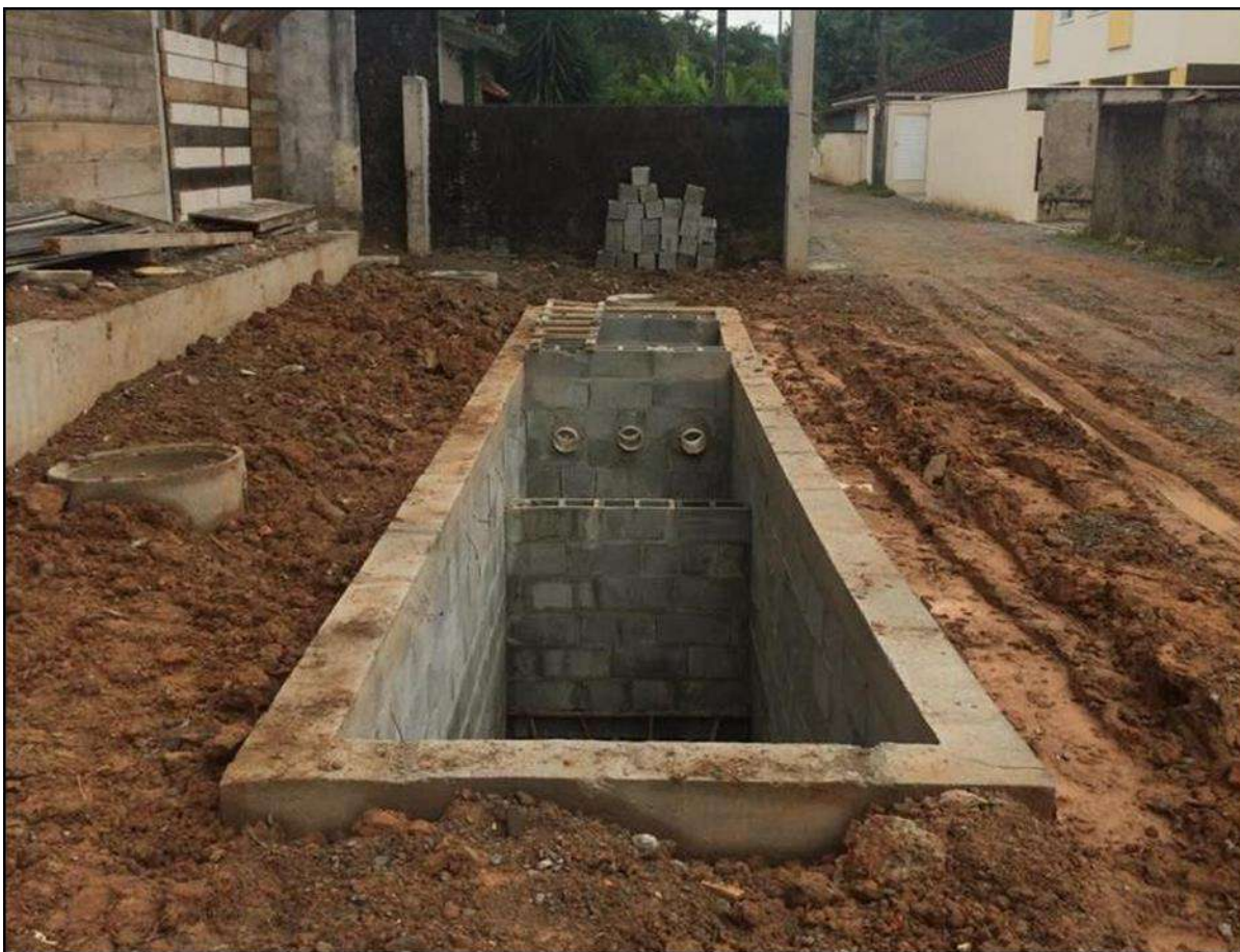
Figura 40. ETE- estação de tratamento de esgoto. Autor: DBio, 2020.
