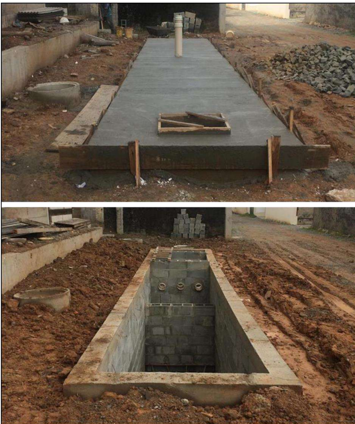
Figura 49. ETE - Estação de tratamento de esgoto do empreendimento. Autor: DBio, 2020.
