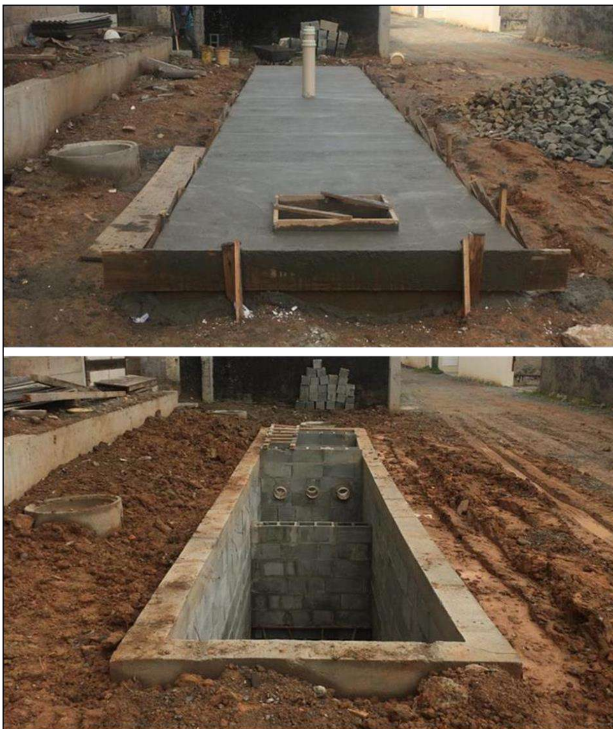
Figura 57. ETE - Estação de tratamento de esgoto do empreendimento. Autor: DBio, 2020.
