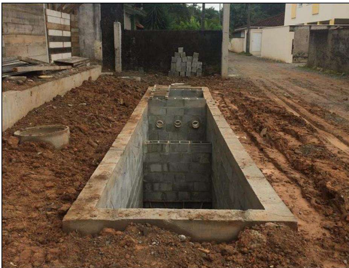
Figura 48. ETE- estação de tratamento de esgoto. Autor: DBio, 2020.
