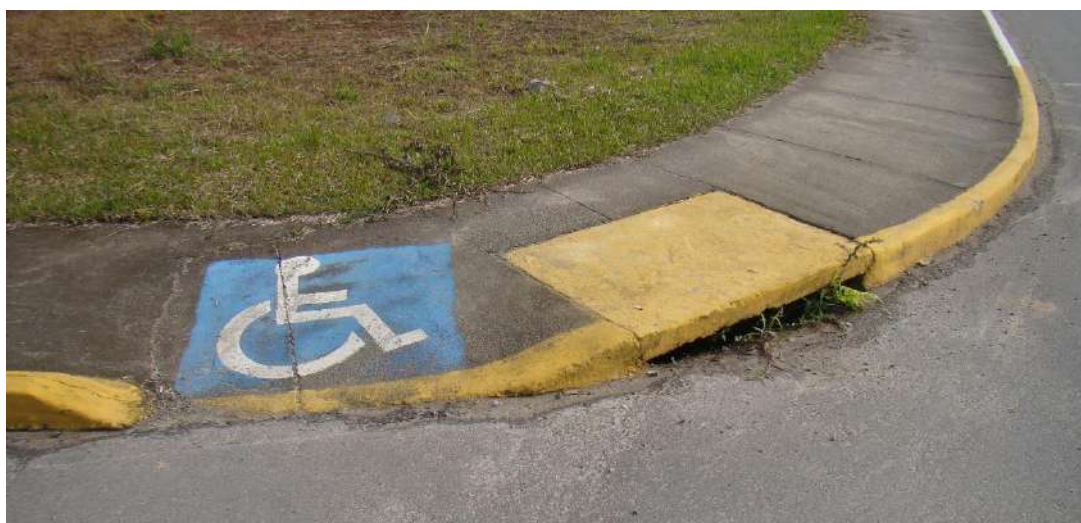
Figura 72. Rampas de cadeirante no loteamento.
