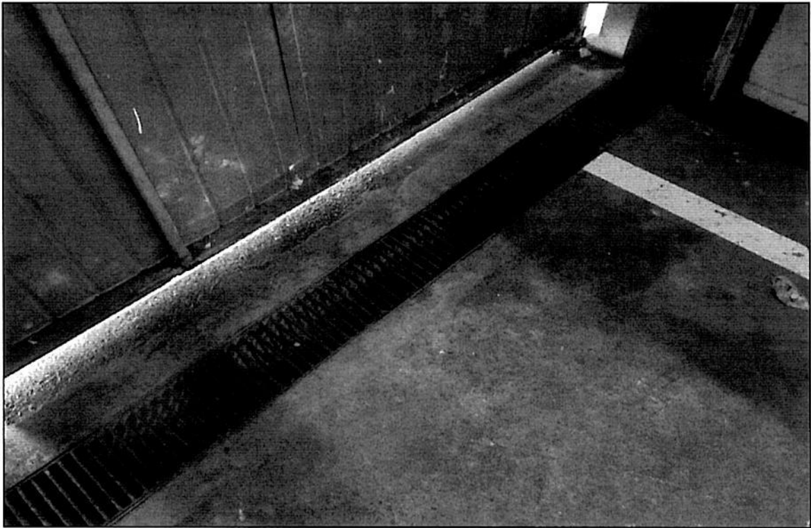
Figura 2- Canaletas com Bacia de Contenção
