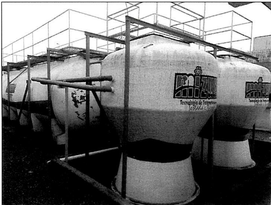
Figura 8 - Estação de Tratamento de Esgotos - ETE
