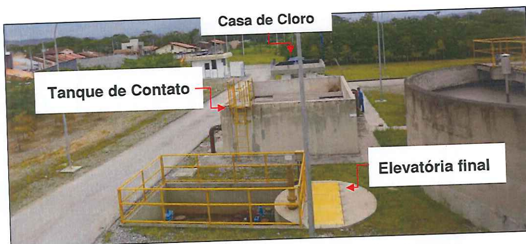
Figura 16: Casa de cloro, tanque de contato e elevatória final.
