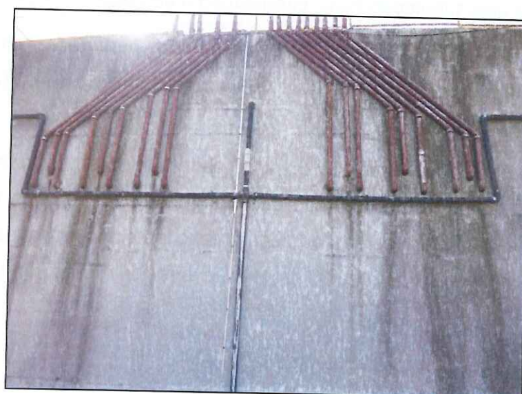
Figura 7: Sinais de vazamento no RAFA.
