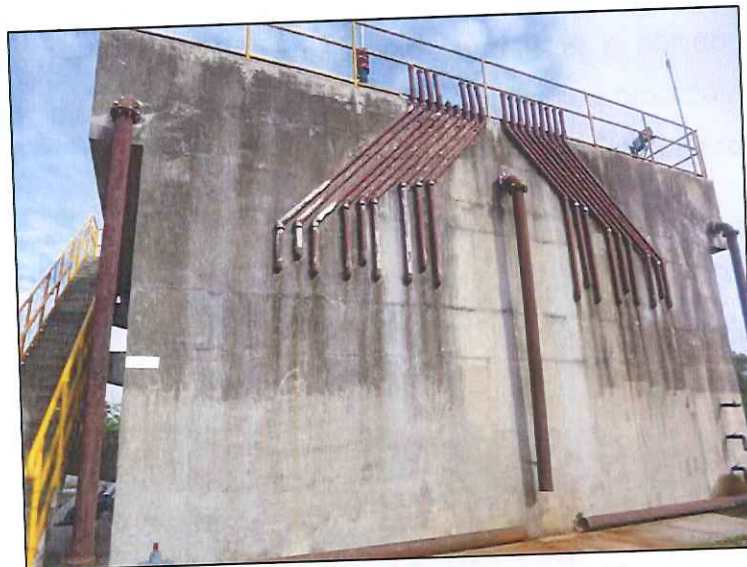
Figura 8: Sinais de vazamento no RAFA.
