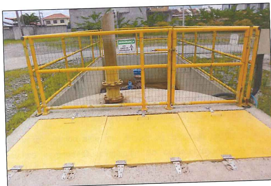
Figura 17: Estação elevatória final de efluentes tratados.
