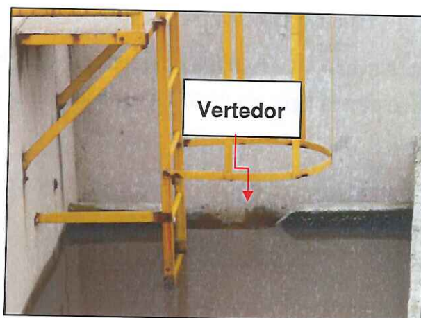
Figura 15: Vertedor de saída do tanque de contato.
