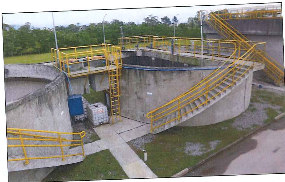
Figura 10: Tanques de Aeração.
