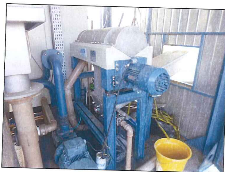
Figura 12: SKID com flotor por ar dissolvido e decanter centrífugo.
