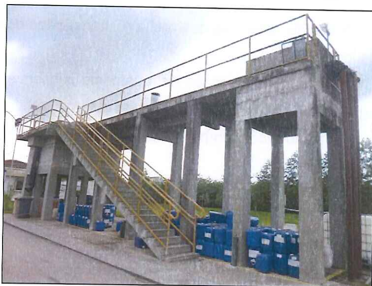
Figura 4: Pré-tratamento da ETE Espinheiros e locais para armazenamento de bombonas vazias e produtos químicos.
