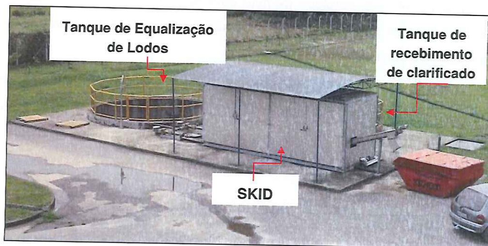
Figura 11: Estação de Tratamento de Lodo (ETL).
