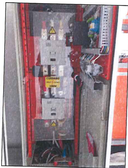
Figura 22: Painel de Comando da ETE Espinheiros.
