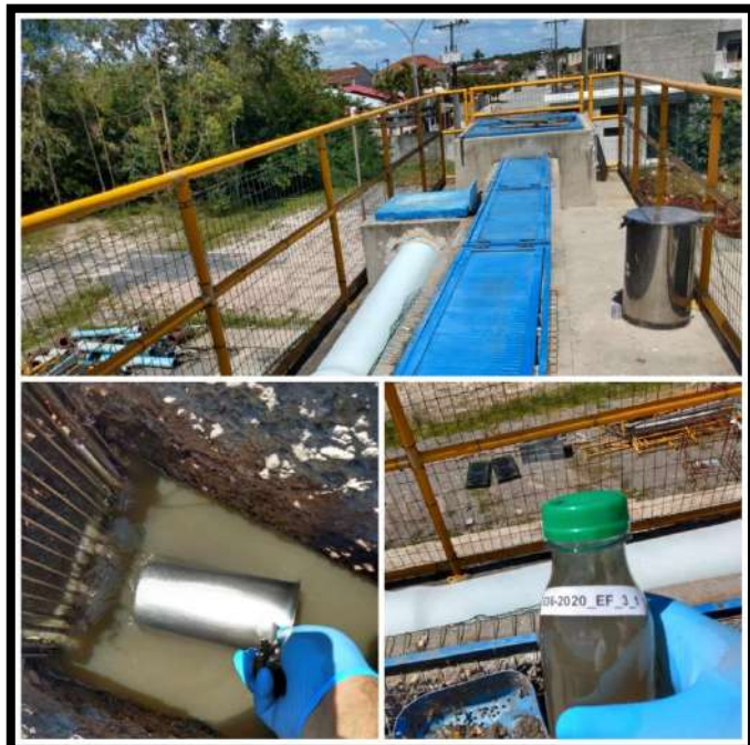
Entrada ETE Espinheiros
