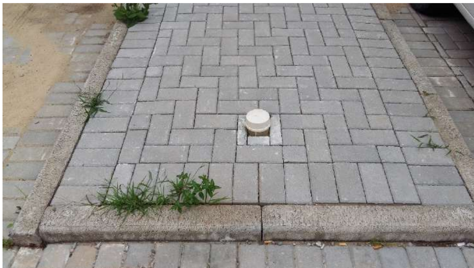
Figura 73: Ponto de inspeção do tanque do sistema de tratamento do esgoto, galpão 01 Fonte: Autor
