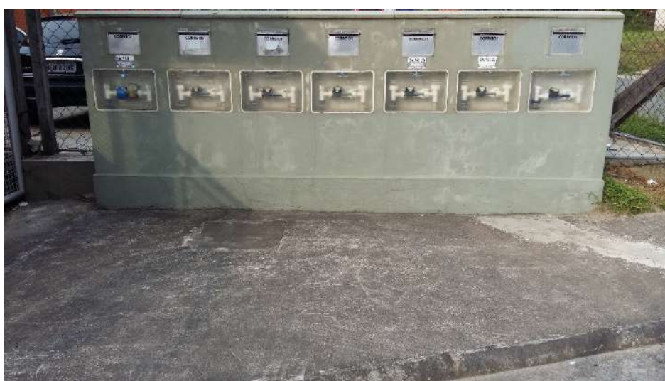
Figura 70: Hidrômetros do empreendimento Fonte: Autor
