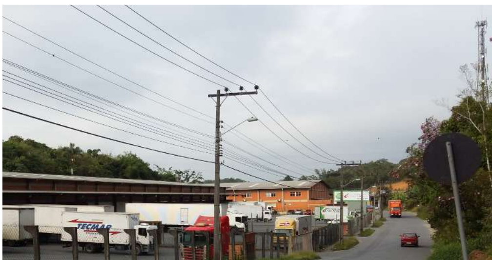
Figura 84: Rede de iluminação pública em frente ao empreendimento Fonte: Autor
