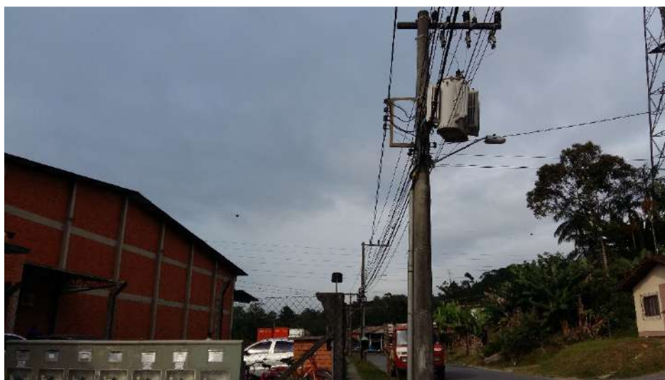
Figura 75: Rede de energia elétrica na rua Portugal e transformador da rede em frente ao empreendimento Fonte: Autor
