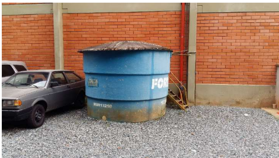
Figura 71: Reservatório de água, galpão 01 Fonte: Autor
