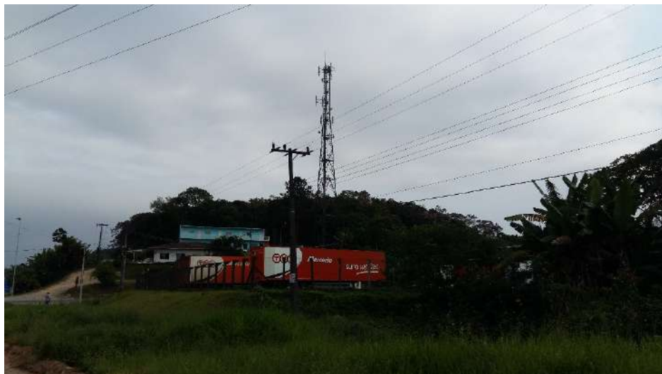
Figura 77: Torre de telefonia, nas proximidades do imóvel Fonte: Autor
