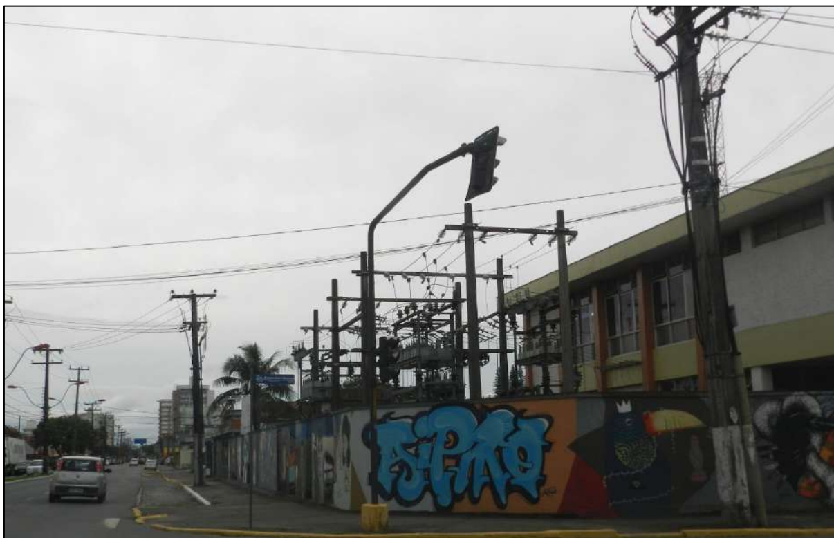
Figura 55: Uso de Serviços – Energia Elétrica (Ponto 23).
