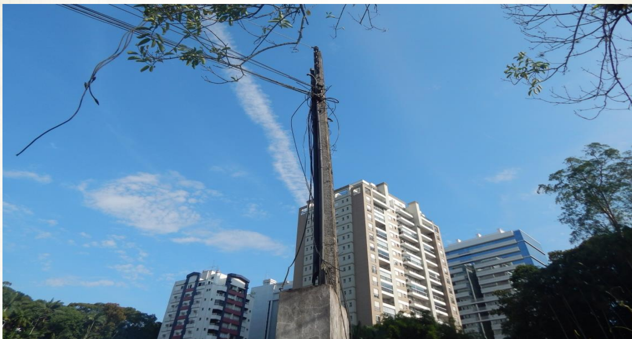
Figura 41 - Poste de entrada de energia antiga.
