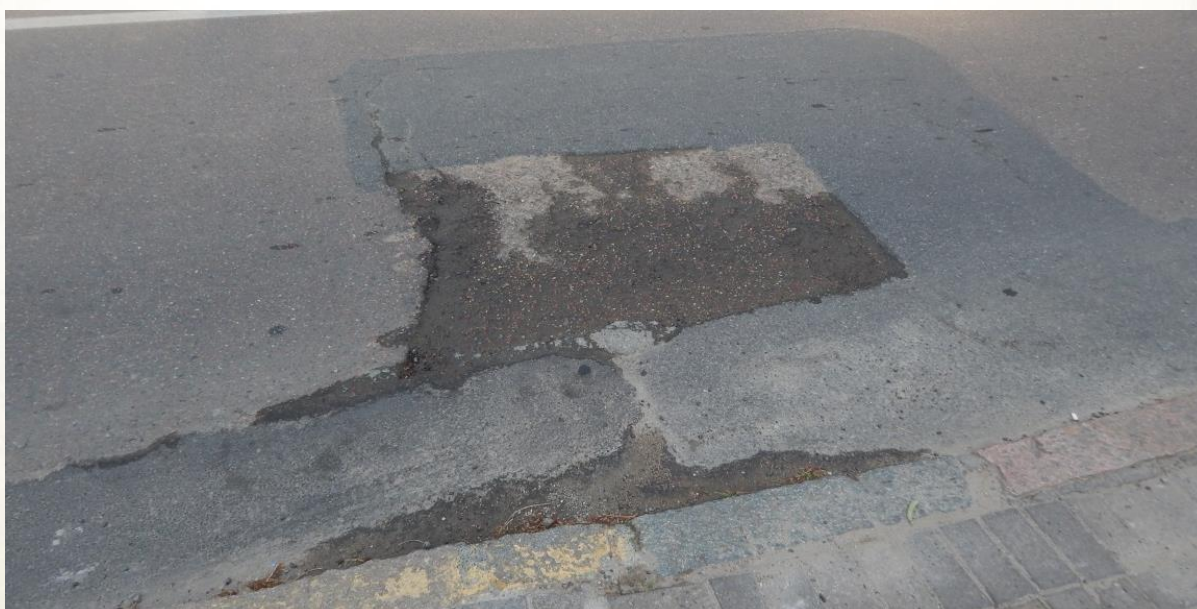
Figura 44 - Problemas apresentados na pavimentação da Rua Otto Boehm – 23.02.2017
