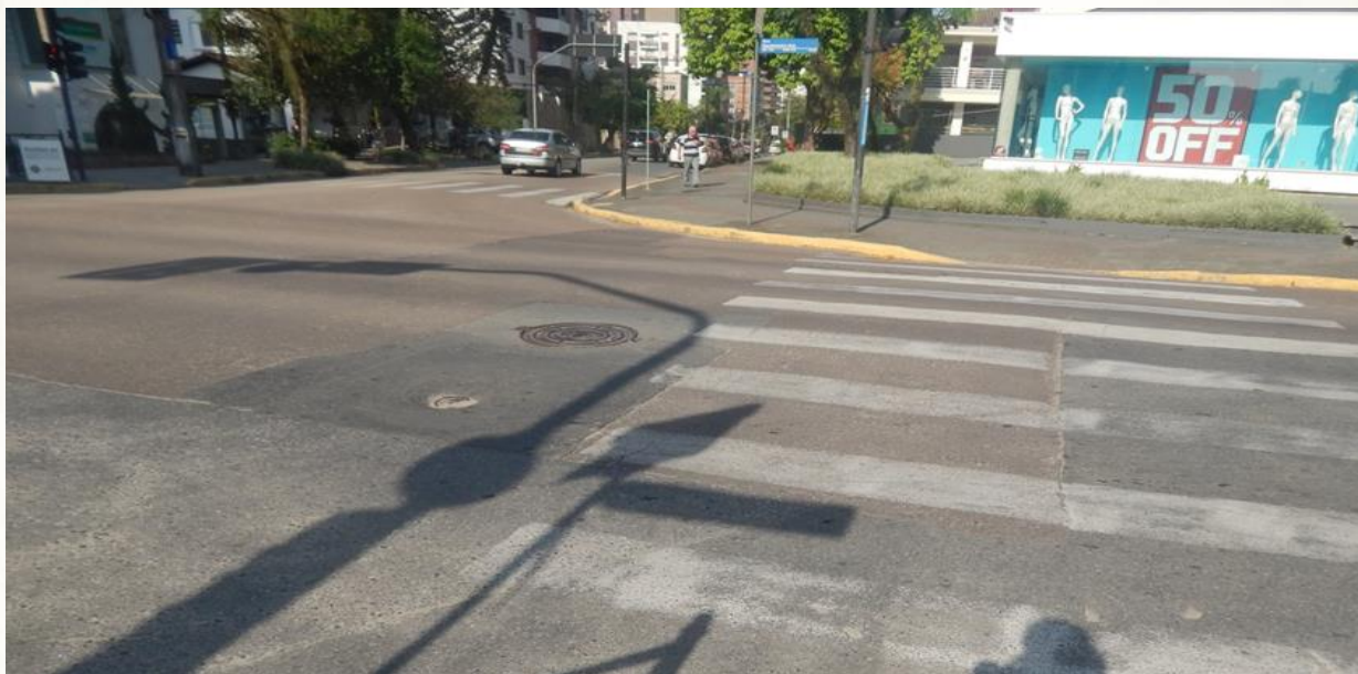
Figura 45 - Problemas apresentados na pavimentação da Rua Expedicionário Holz - 23.02.2017
