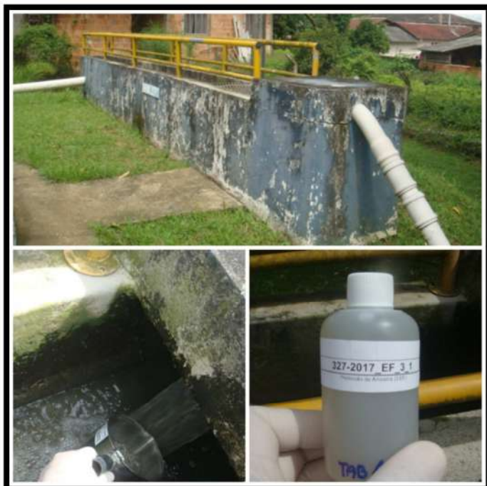
ETE Profipo Entrada
