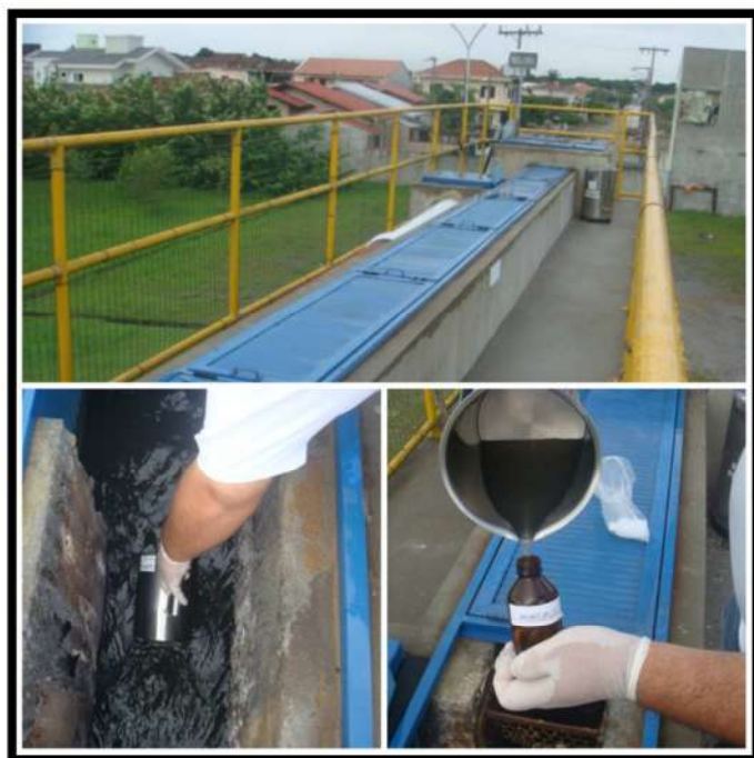
Entrada ETE Espinheiros
