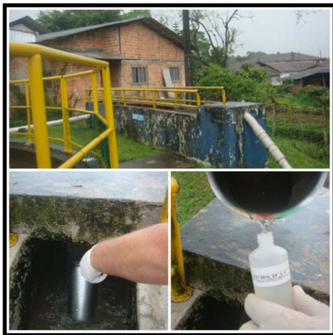
Entrada ETE Profipo
