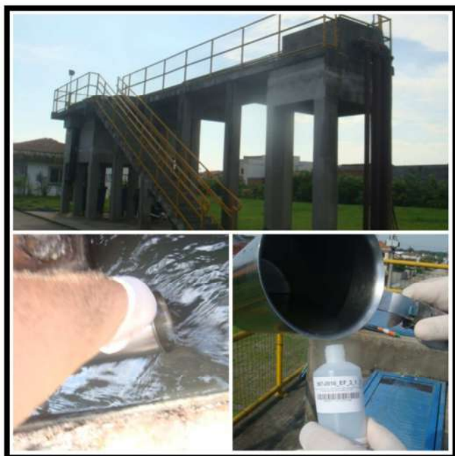
Entrada ETE Espinheiros
