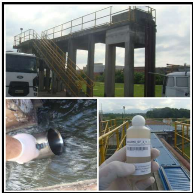
Entrada ETE Espinheiros
