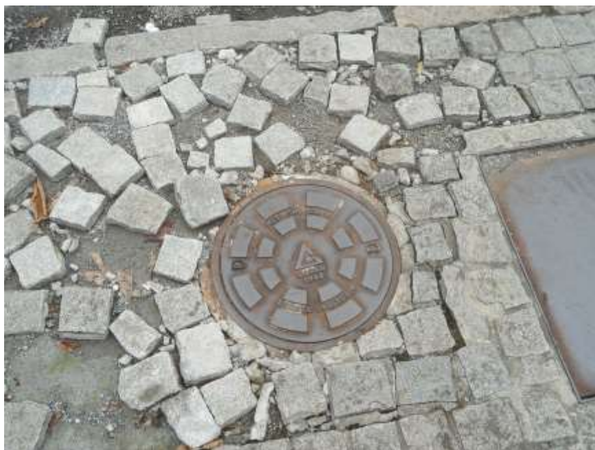
Figura 58: Rede de esgoto – Rua Orestes Guimarães.
