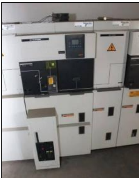
Figura 26: Painéis da subestação de energia do empreendimento.
