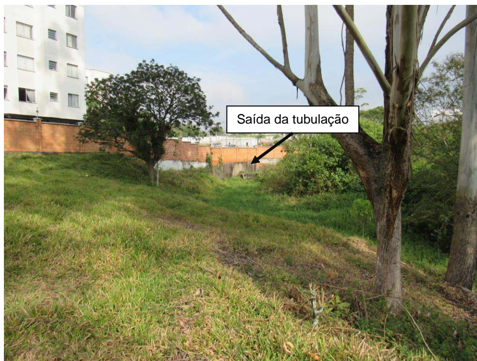
Figura 19: Trecho aberto 5, vegetação isolada, vista para tubulação. Fonte: Autores.
