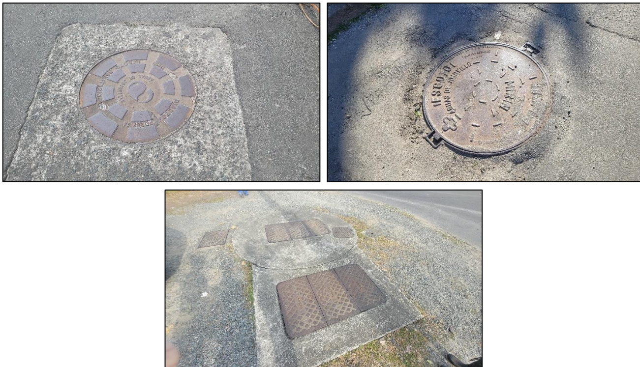
Figura 12 – Infraestrutura de coleta de esgoto.
