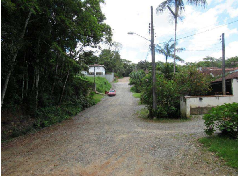
Figura 11: Linha de distribuição de energia elétrica, rua Cidade de Mafra. Fonte: Autores.
