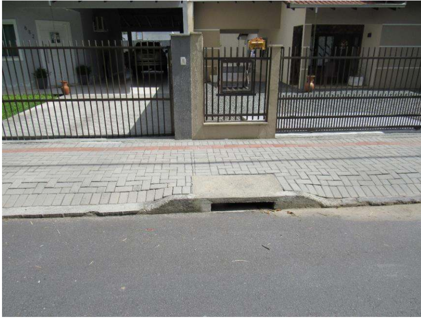
Figura 13: Boca de lobo na rua Francisco Bernardo Boettcher, trecho 25. Fonte: Autores.
