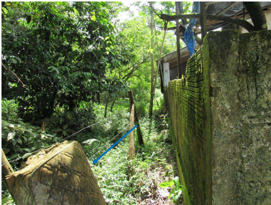
Figura 37: Contexto das margens do trecho 22, fundos de residência, anterior a interceptar a rua Vinte e Dois de Maio, vista para montante. Fonte: Autores.
