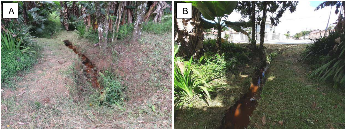
Figura 20: A: Trecho 25 para 13B; B: Trecho 13B, vista para jusante. Fonte: Autores.
