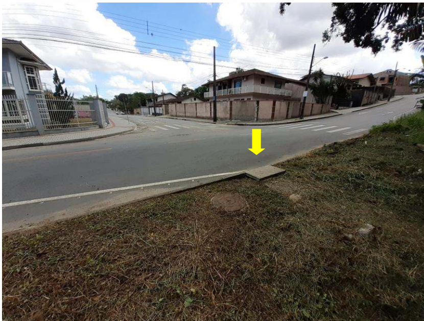
Figura 12: Boca de lobo integrado ao trecho 25, rua Francisco Bernardo Boettcher. Fonte: Autores.
