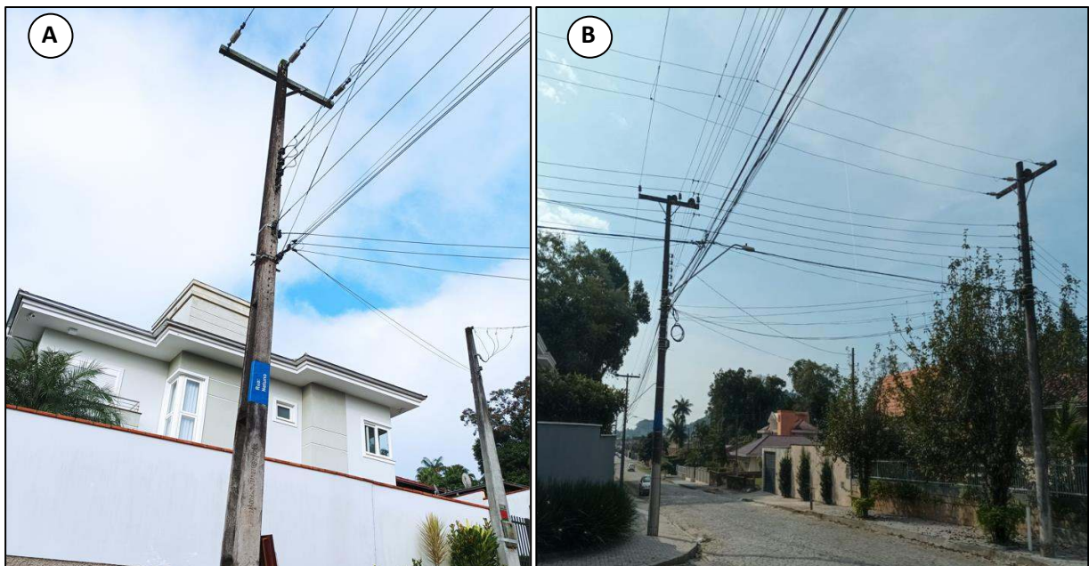
Figura 38: Postes e fiação elétrica presentes na área de estudo. Legenda: A - Registro realizado na Rua Netuno, próximo ao trecho 1. Fonte: vistoria realizada no dia 10/05/2022 pela equipe técnica da Bioeco. B – Registro realizado na Rua Silva Jardim, próximo ao trecho 3. Fonte: vistoria realizada no dia 26/05/2022 pela equipe técnica da Bioeco.
