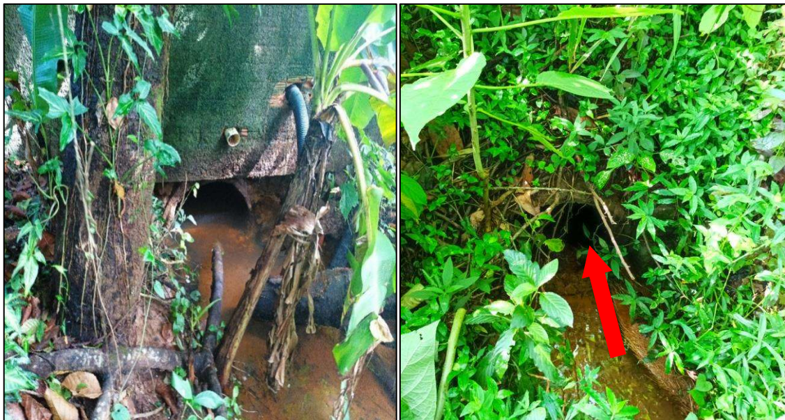
Figura 49: Tubulação de ligação de corpo d'água aberto à rede de drenagem. Legenda: A – Entrada do trecho 3. B – Ligação de saída do trecho 3. Fonte: vistoria realizada no dia 10/05/2022 pela equipe técnica da Bioeco.
