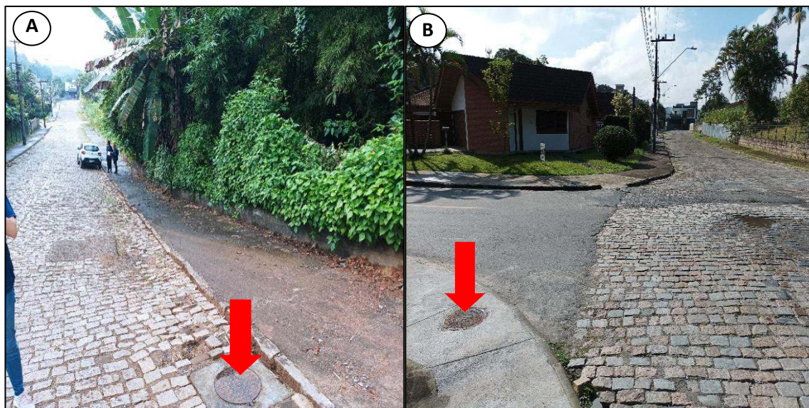
Figura 45: Poços de Inspeção de rede coletora de esgoto sanitário. Legenda: A – Registro de poço de inspeção localizado na Rua Netuno, próximo ao trecho 1. B – Poço de visita localizado na esquina entre as Ruas Netuno e José Bonifácio, próximo ao trecho 2A. Fonte: vistoria realizada no dia 10/05/2022 pela equipe técnica da Bioeco.
