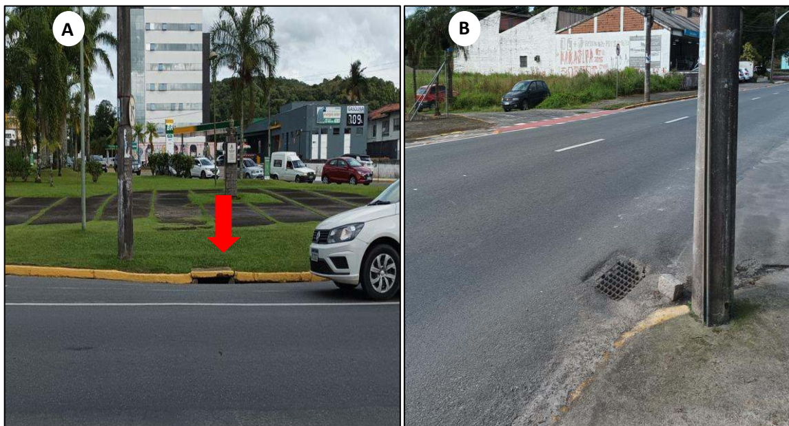
Figura 47: Bocas de lobo. Legenda: A – Registro boca de lobo tipo guia localizada na Rua XV de Novembro, próxima ao trecho 5A. B – Boca de lobo tipo guia localizada na Rua XV de Novembro, próximo ao trecho 5A. Fonte: vistoria realizada no dia 10/05/2022 pela equipe técnica da Bioeco.
