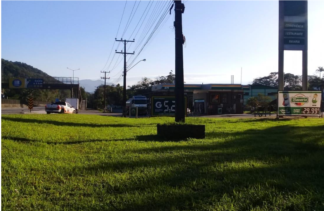
Figura 28: Rede de distribuição de energia elétrica às margens da rodovia Gov. Mário Covas.
