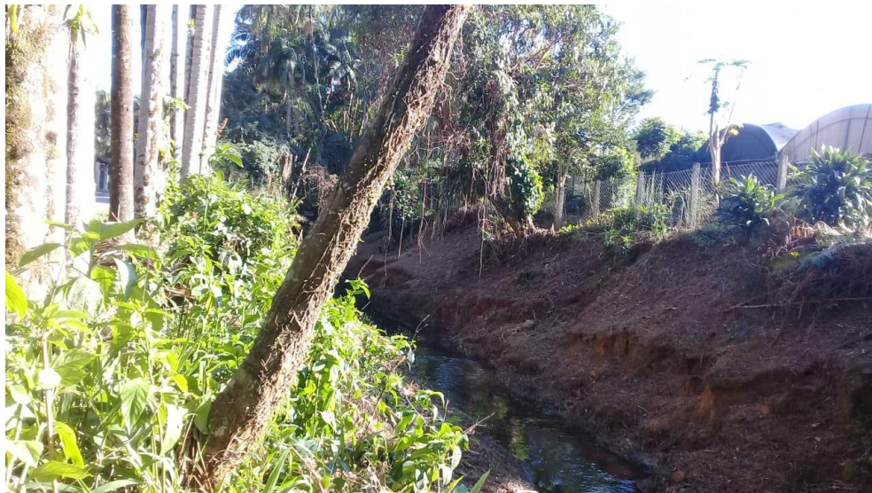
Figura 71: Trecho 77, fundos da floricultura Recanto do Jardim, vista para montante. Observa-se margem sem vegetação com processos erosivos.
