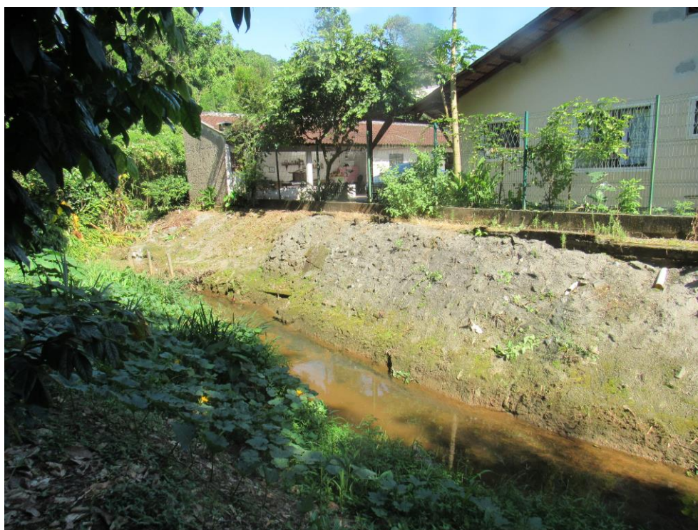
Figura 59: Trecho 49, próximo à rua 4 de fevereiro. Fonte: Autores.
