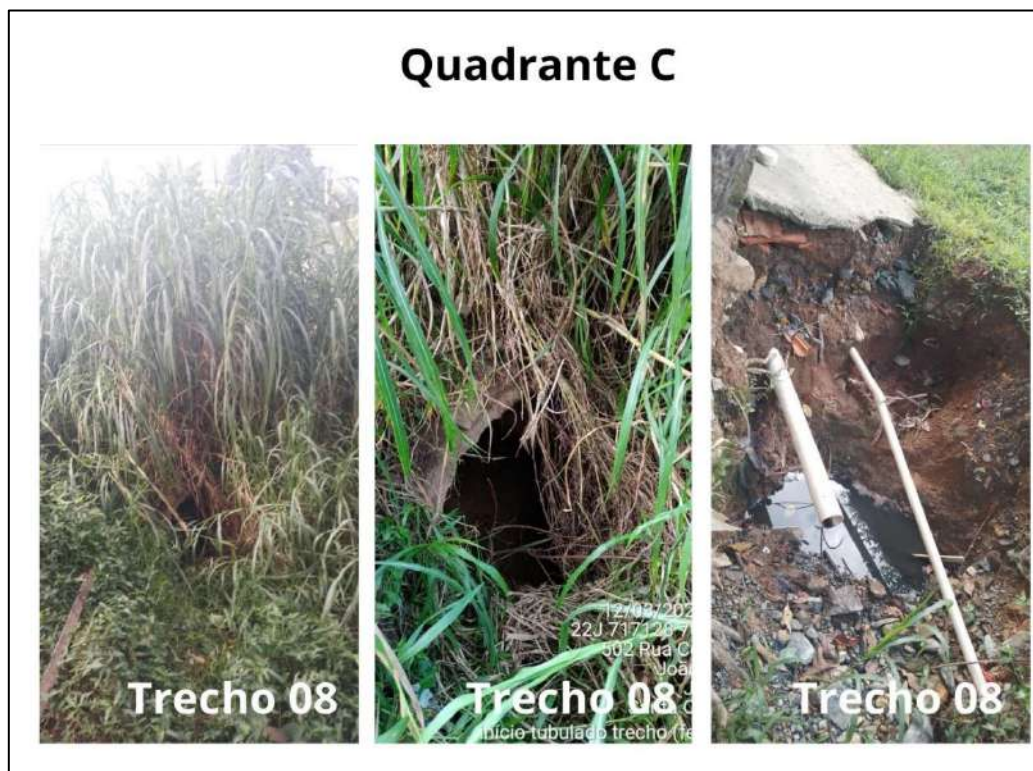
Figura 27: Trechos Quadrante C; Coordenadas UTM (x,y): Trecho 8 tubo aberto esgoto (717123.21 m E, 7084187.15 m S)
