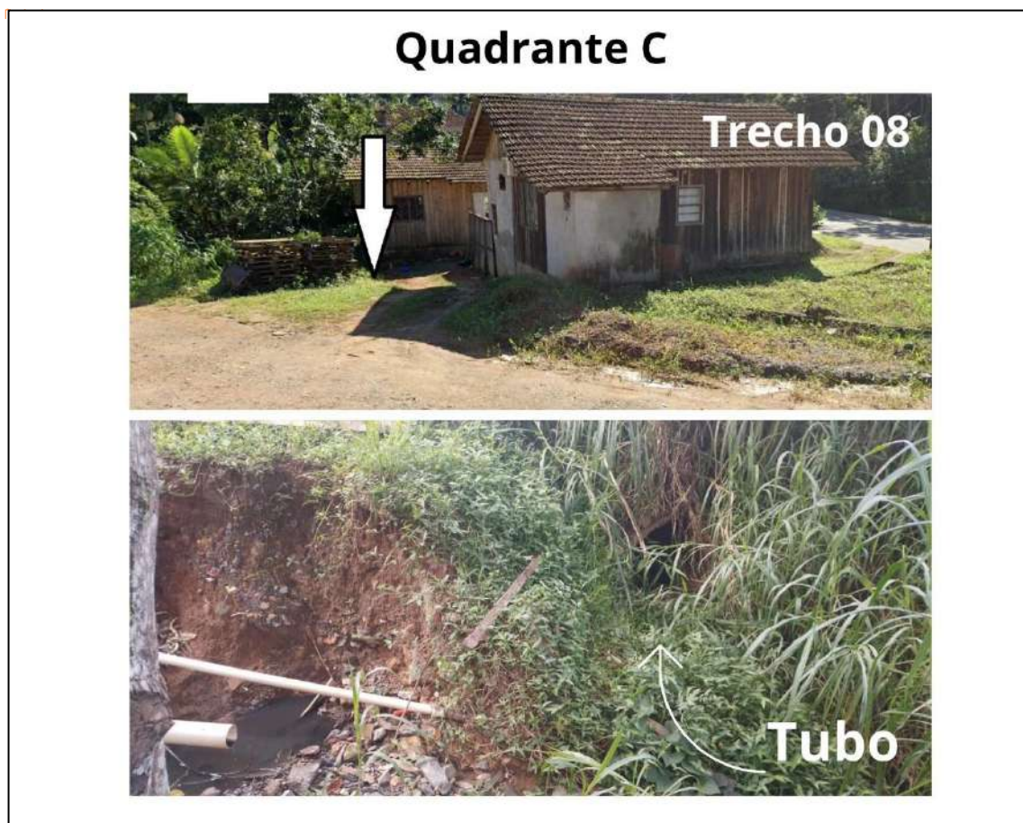
Figura 28: Trechos Quadrante C; Coordenadas UTM (x,y): Trecho 8 tubo aberto esgoto (717123.21 m E, 7084187.15 m S)
