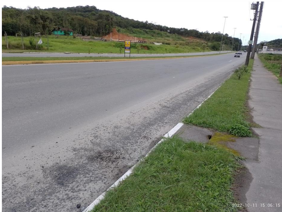
Figura 10: Boca de lobo e linhas de distribuição de energia na av. Plácido Hugo de Oliveira. Fonte: Autores.
