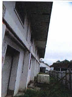
Imagem 41. Vistoria Cidadela Cultural Antarctica (Bloco 10, lateral). Fonte: CPC/SECULT. Data da foto: 17.05.2018.
