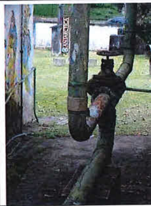
Imagem 16. Vistoria Cidadela Cultural Antarctica (tubulação no acesso entre os Blocos 3, 4 e 5). Fonte: CPC/SECULT. Data da foto: 17.05.2018.
