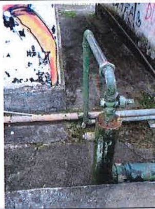
Imagem 15. Vistoria Cidadela Cultural Antarctica (tubulação no acesso entre os Blocos 3, 4 e 5). Fonte: CPC/SECULT. Data da foto: 17.05.2018.
