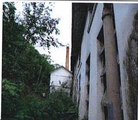
Imagem 40. Vistoria Cidadela Cultural Antarctica. Fonte: CPC/SECULT (Bloco 10, fundos). Data da foto: 17.05.2018.
