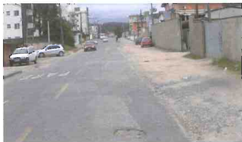
Foto 16: : Remendo, Trincas Classe 3 (FC3), Panela e Desgaste .
