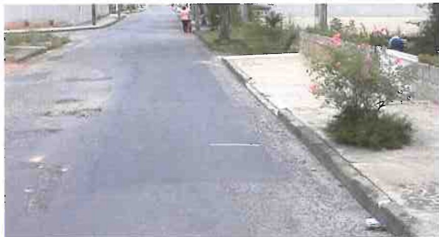
Foto 08: Painela, Remendos, Trincas e Desgaste
