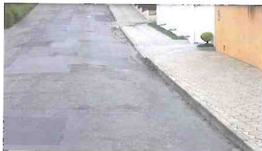
Foto 04: Remendo/Ondulação, Trincas e ondulações
