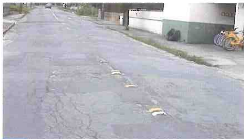
Foto 02: Remendo/Ondulação, Trincas Classe 3 (FC3)
