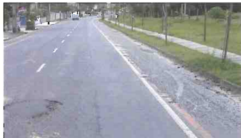
Foto 11: Remendo, Trincas, Desgaste e Deformação
