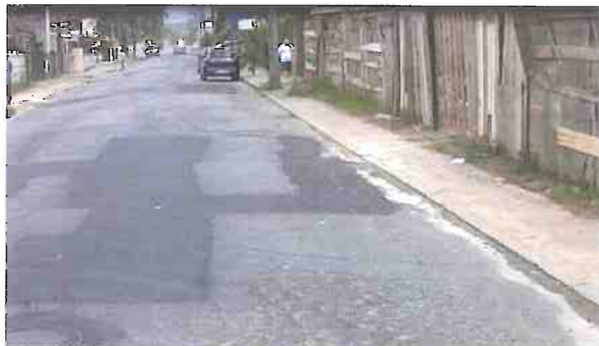
Foto 05: Painela, Remendos, Trincas e Desgaste
