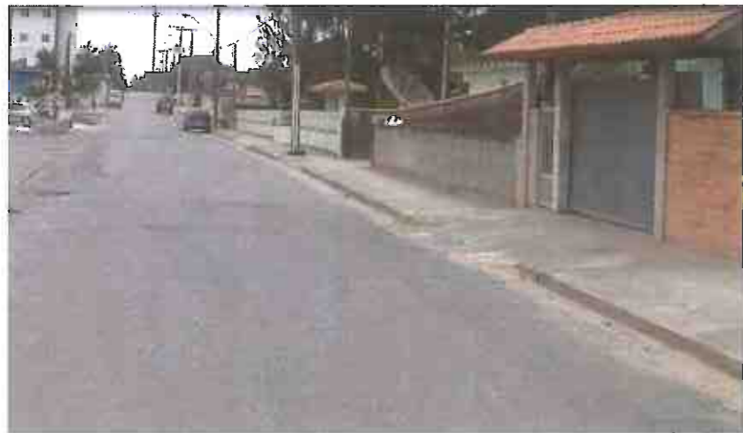
Foto 18: Remendo, Trincas e Panela.
