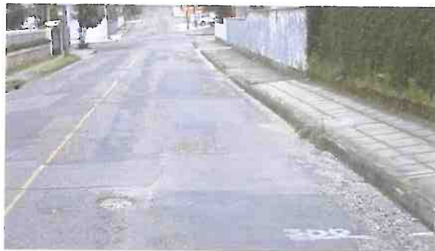
Foto 03: Paveamento, Remendos, Trincas e Desgaste
