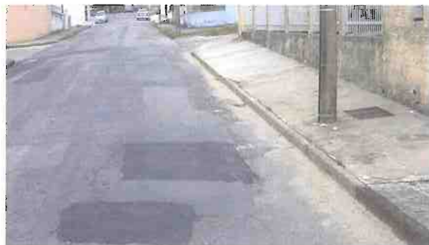
Foto 01: Remendo/Ondulação, Trincas Classe 3 (FC3) e Desgaste
