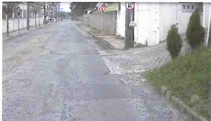
Foto 06: Indícios de Abertura de Vala, Remendos, Trincas e Ondulações
