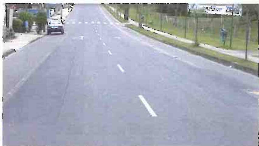
Foto 10: Remendo, Trincas Classe 3 (FC3)
