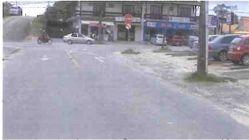
Foto 17: R emendo, Trincas Classe 2 e ATC.
