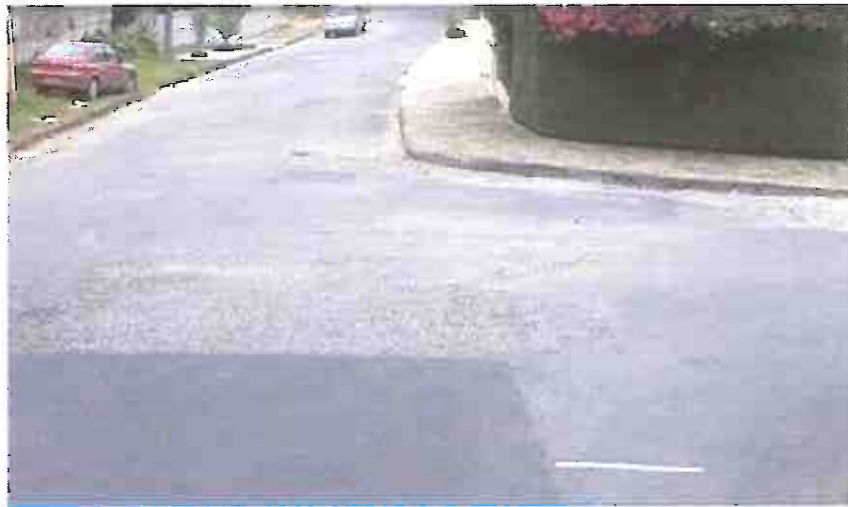
Foto 07: Painela, Remendos, Trincas e Desgaste
