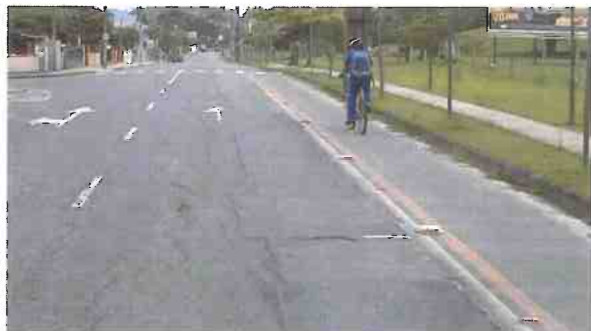
Foto 09: Remendo, Trincas Classe 2 (FC2) e Deformação
