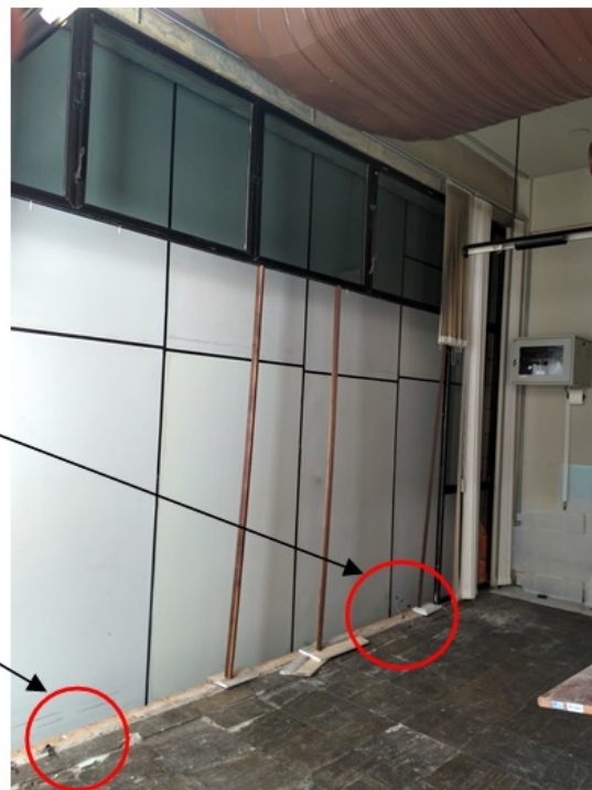
Imagem 09 – Área interna onde ocorreu o desabamento da parede e o consequente arrancamento da instalação elétrica. Fonte: BP - SEINFRA
