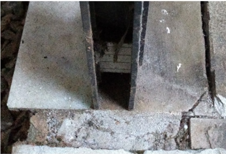
Imagem 07 Detalhe da soleira original da sala que teve sua alvenaria de fechamento demolida pela ação do vento. Fonte: BP – SEINFRA, 2019.
