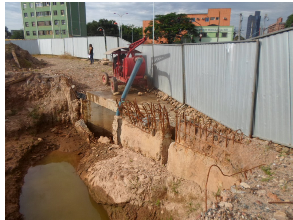
FOTO 04 - VISTA DAS LAMELAS A PARTIR DA POSIÇÃO NORTE PARA OESTE
