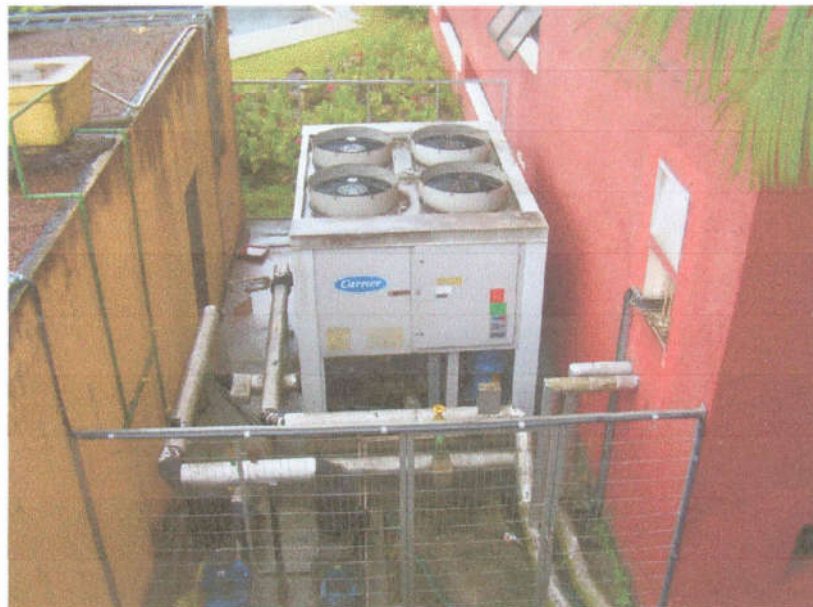
Foto: Chiller existente
