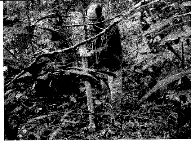
Foto 34 – Realização de tradagens nas áreas destinadas a implantação dos decks, nas proximidades da rua Pastor Guilherme Rau.
