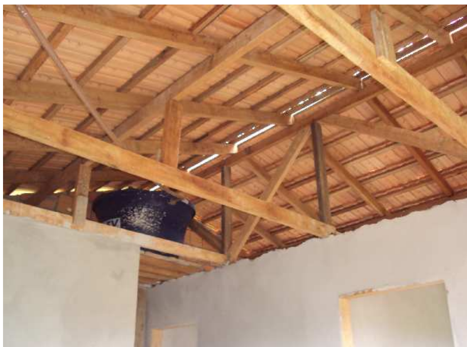
Foto 5 – Cobertura em telha francesa – Fiscalização Prefeitura Municipal de Joinville
