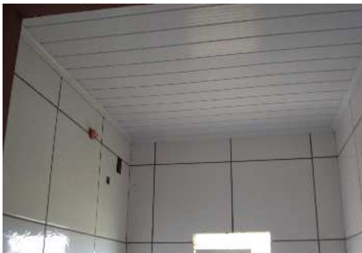
Foto 4 – Forro em PVC
