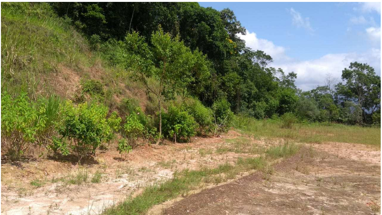
Barranco no terreno no limite aos fundos e ao lado direito.
