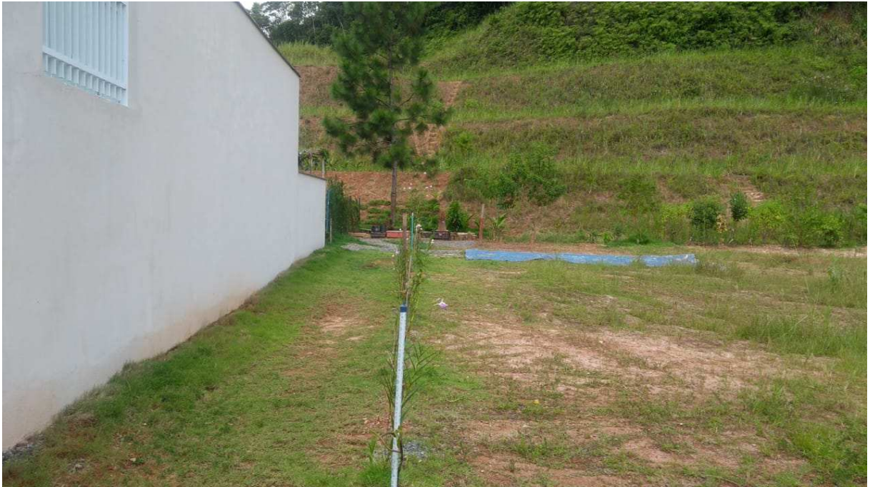
Barranco no terreno no limite aos fundos e ao lado esquerdo.
