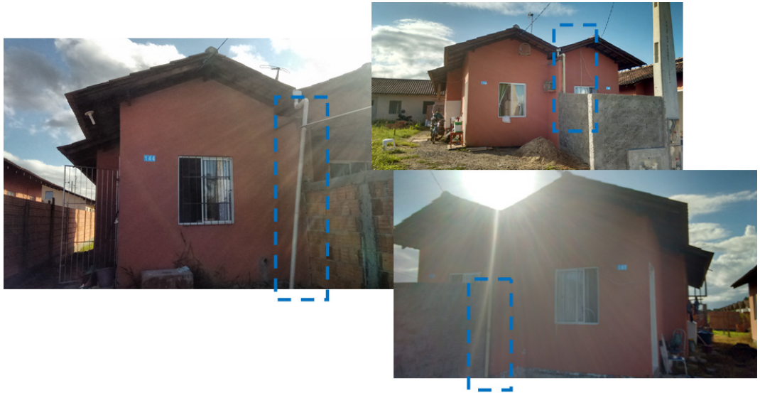
Imagem 16A – Conflitos existentes no que se refere à distribuição de águas pluviais.
