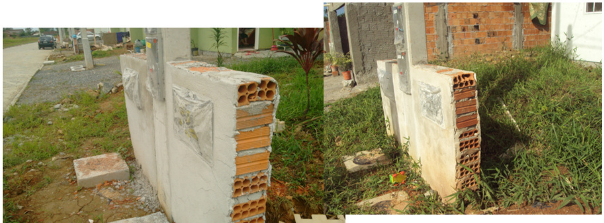
Imagem 14 – Exemplos de muretas dos hidrômetros das Unidades Habitacionais (60/64 e 130/134) sem reboco e fora do prumo.
