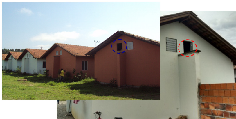
Imagem 10 – Falta da porta/veneziana.
