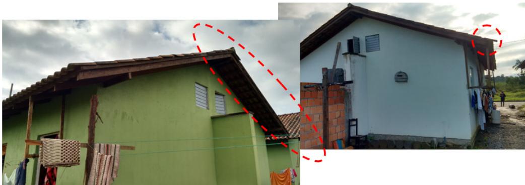
Imagem 18A – Telhas do beiral derrubadas ou soltas.
