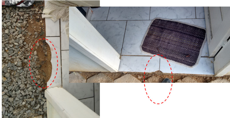
Imagem 13 – Pisos na soleira da porta de entrada quebrados.
