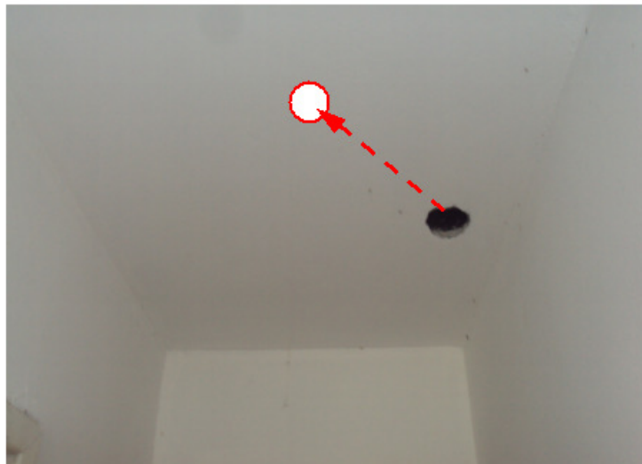
Imagem 8 – ponto de luz “mal locado”.
